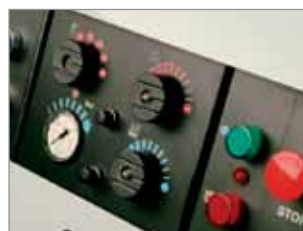
PAINEL DE CONTROLO COM BOTÃO DE PARAGEM DE EMERGÊNCIA
